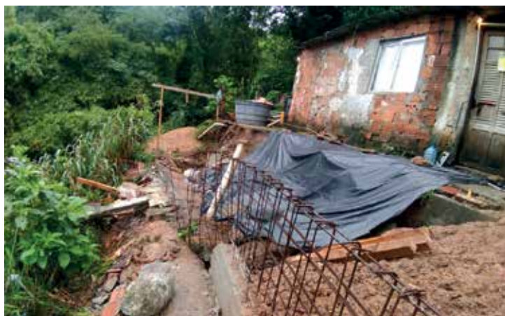
Deslizamento parcial do terreno de uma residência e obras de recuperação
